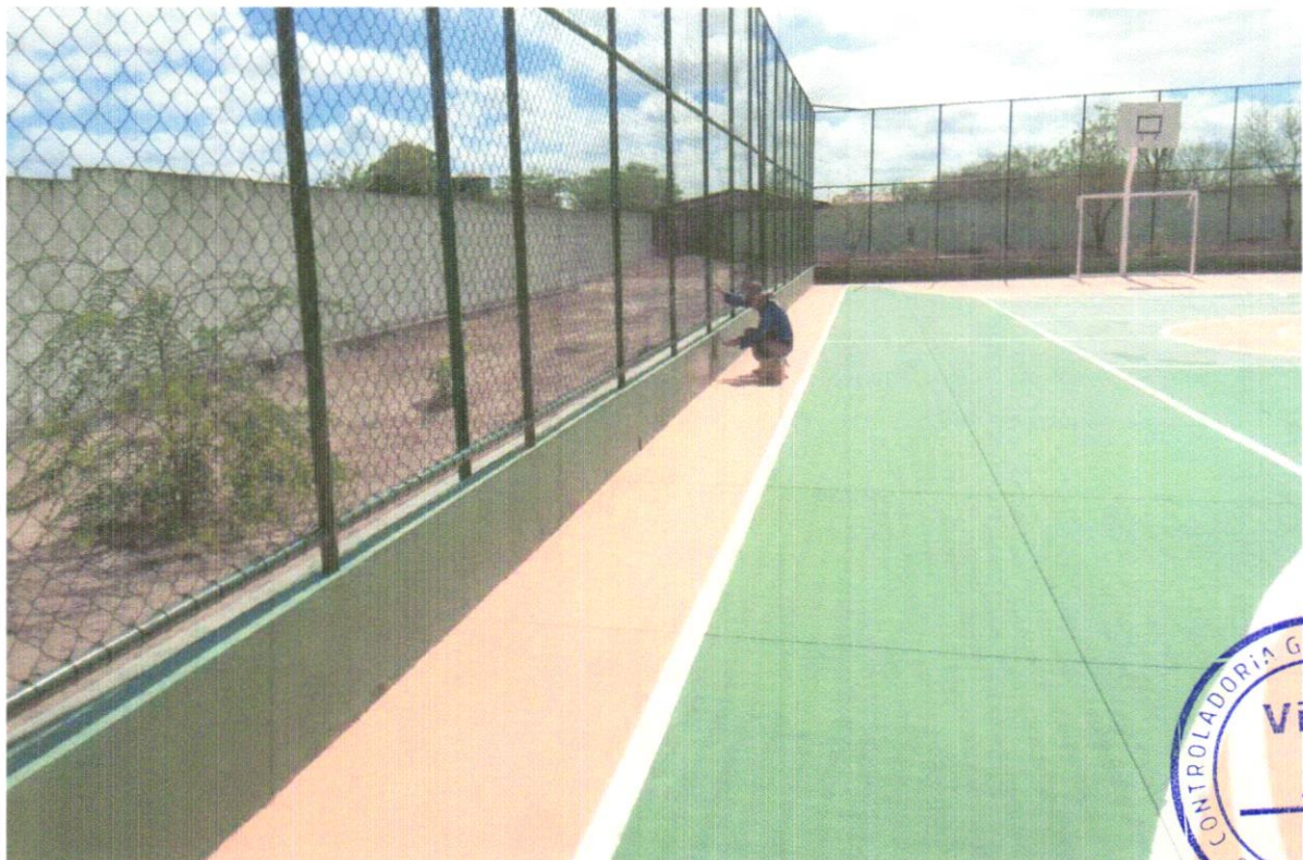
FOTO 22 – APLICAÇÃO MANUAL DE PINTURA COM TINTA LÁTEX ACRÍLICA EM PAREDES, DUAS DEMÃOS. AF_06/2014
