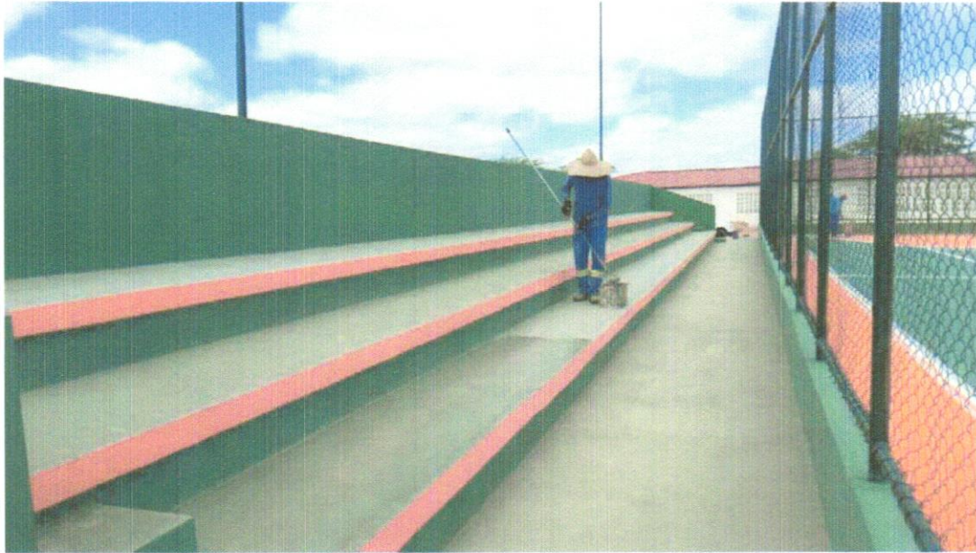
FOTO 13 – APLICAÇÃO MANUAL DE FUNDO SELADOR ACRÍLICO EM SUPERFÍCIES EXTERNAS DE SACADA DE EDIFÍCIOS DE MÚLTIPLOS PAVIMENTOS AF_06/2014
