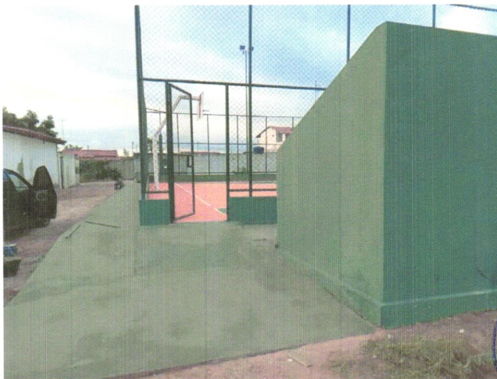
FOTO 18 – APLICAÇÃO DE PISO CIMENTADO, TRAÇO 1:3 (CIMENTO E AREIA), ACABAMENTO LISO, ESPESSURA 4,0 CM, PREPARO MECÂNICO DA ARGAMASSA. AF_09/2020
