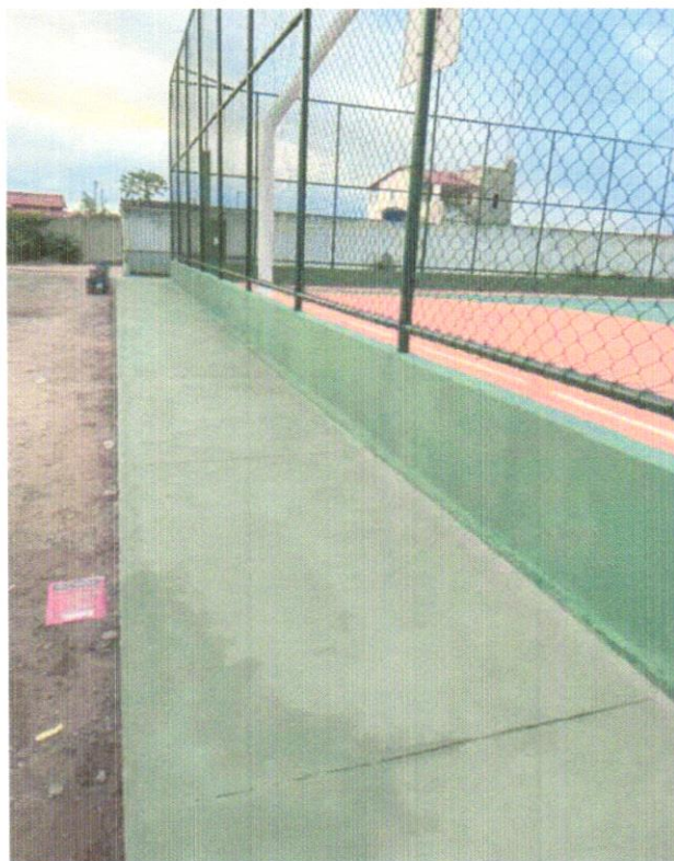
FOTO 15 – APLICAÇÃO DE PISO CIMENTADO, TRAÇO 1:3 (CIMENTO E AREIA), ACABAMENTO LISO, ESPESSURA 4,0 CM, PREPARO MECÂNICO DA ARGAMASSA. AF_09/2020
