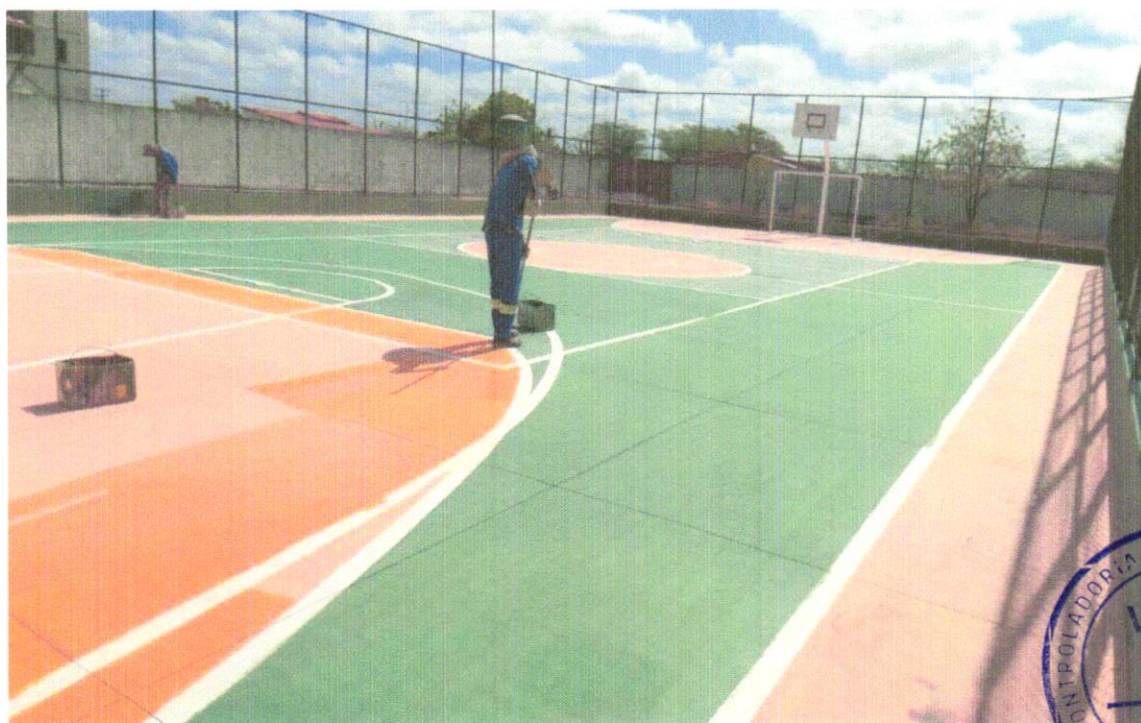
FOTO 10 – PINTURA DE ACABAMENTO COM APLICAÇÃO DE 02 DEMÃOS DE TINTA PVA LÁTEX PARA INTERIORES/EXTERIORES – CORES ESPECIAIS MISTURADAS EM MÁQUINA, TONS CLAROS (MARFIM,PÉROLA,ETC) – REV 01 – (COR LARANJA)
